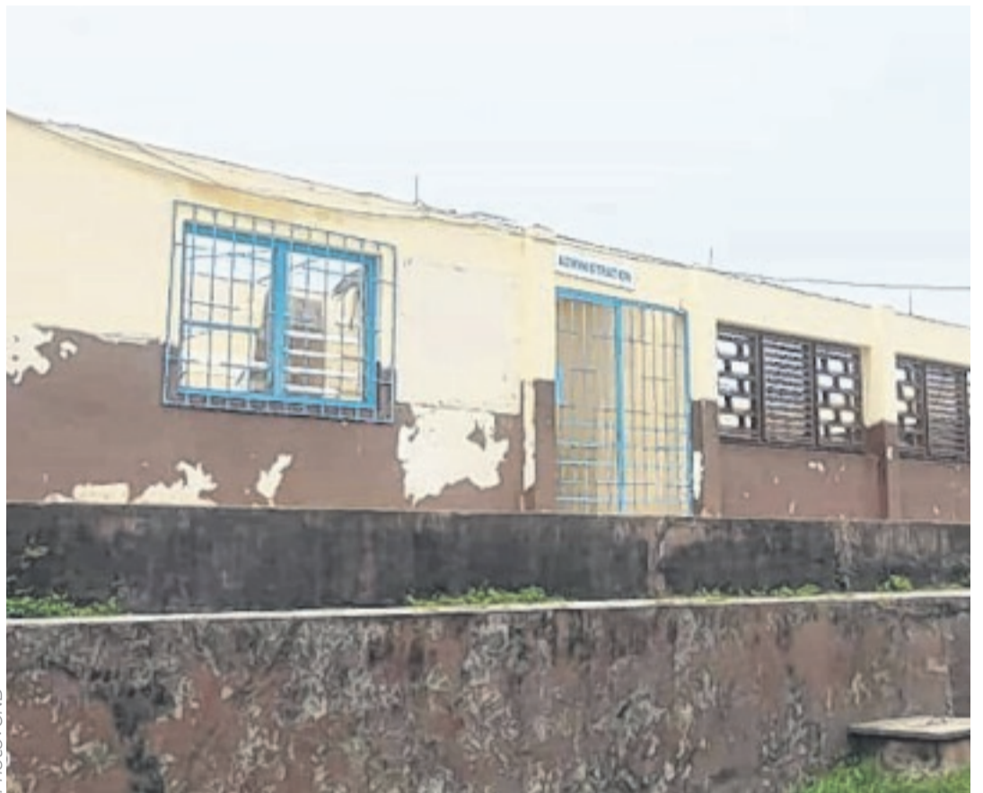
L'école publique d'Ambowè a vu sa toiture emportée le 2 février dernier par le vent.
