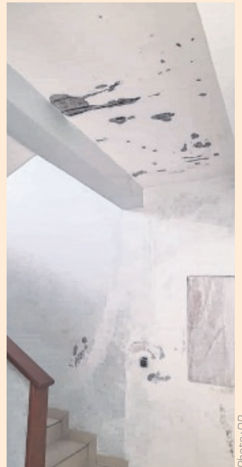
Les dalles semblent remplies d'eau de plus en plus.
