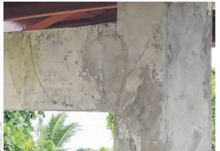
Des fissures déjà visibles sur une poutre.
