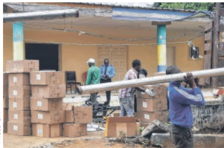
Une vue des panneaux solaires installés.
