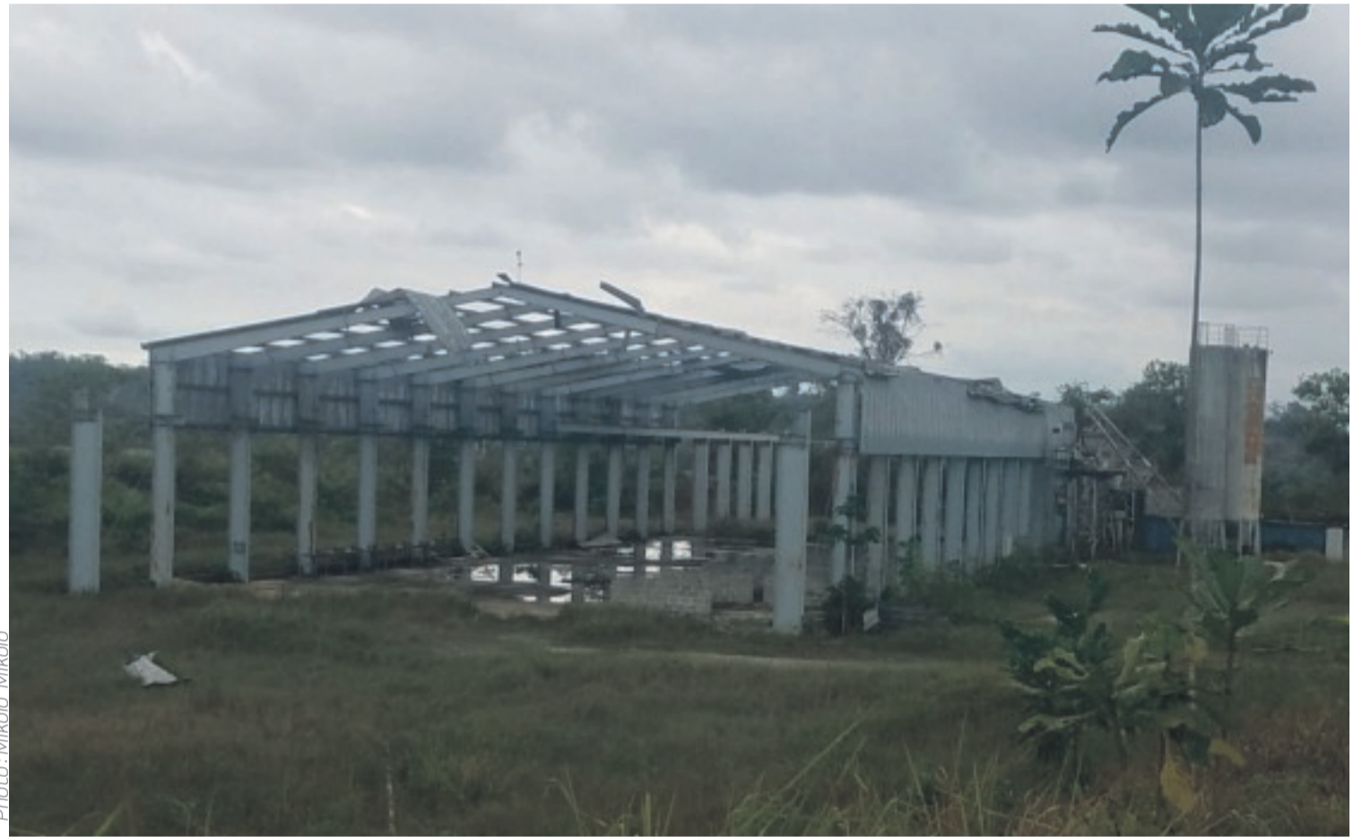
Ce hangar aux allures de squelette montre que les travaux de construction de la prison de Nkoltang ne sont pas allés à terme.
