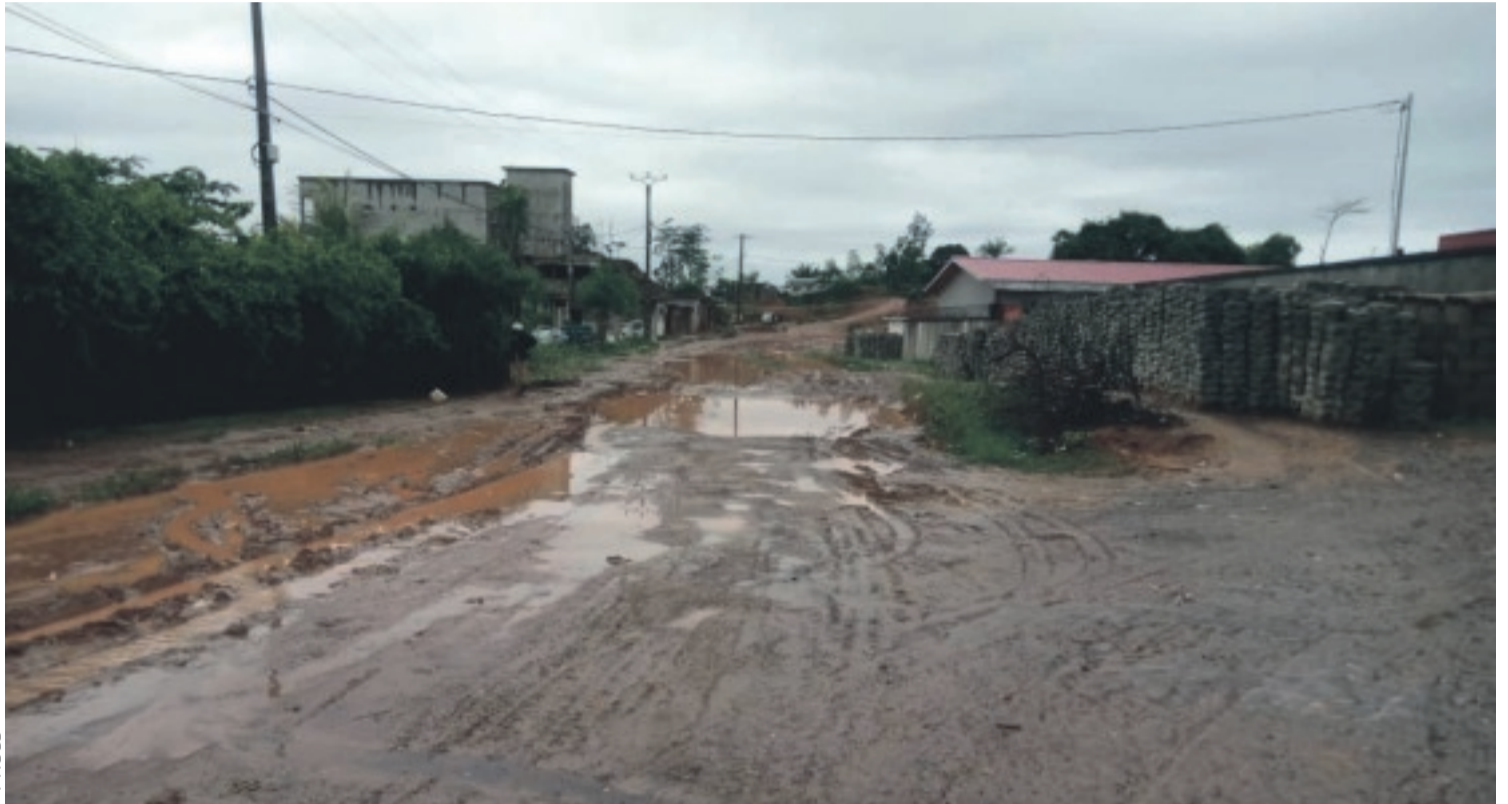
Tel est l'état de cette route dans toute sa longueur. A droite, on aperçoit les pavés fabriqués.
