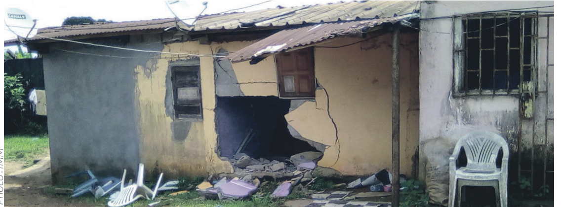
L'impact de l'accident qui a causé la mort de la lycéenne.
