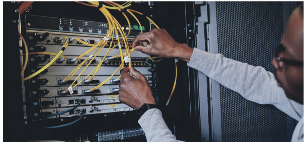
Vue partielle des équipements informatiques
