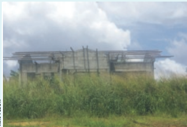
Le bâtiment abandonné devant abriter les locaux de la représentation de Western union à Sam.
