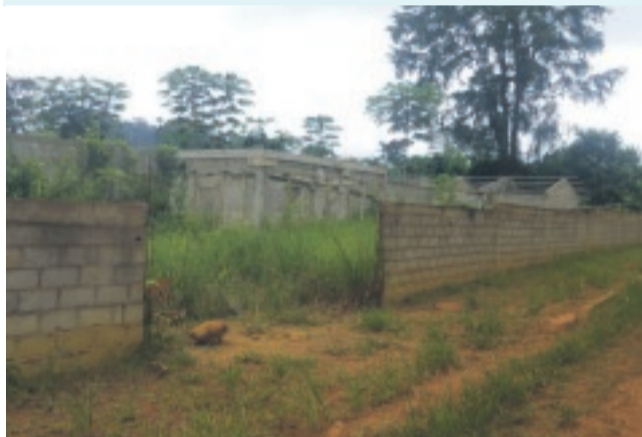
Le chantier de construction du centre de santé à l'abandon.
