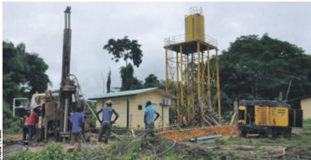
Le forage et le chateau d'eau ont été réalisés sur le site le plus élevé du quartier Nguouassa.
