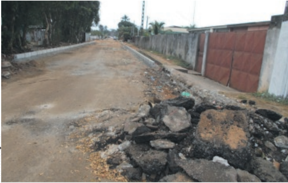
Plusieurs voiries urbaines subissent...
