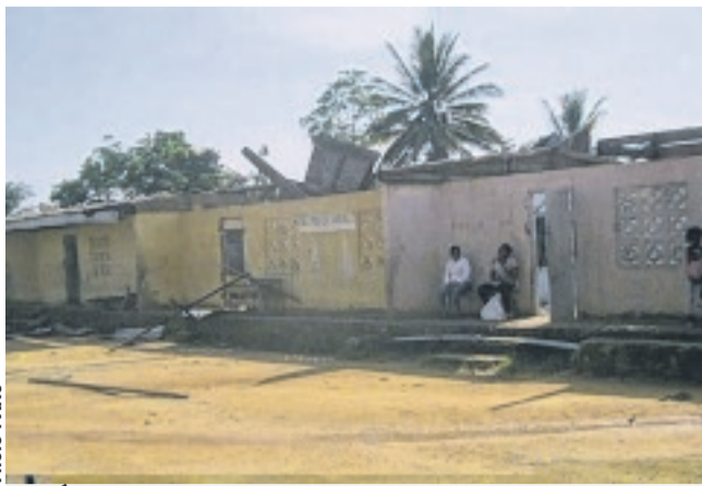
L'école publique de Nguema, dont les toitures de trois bâtiments ont été emportées par l'orage.
