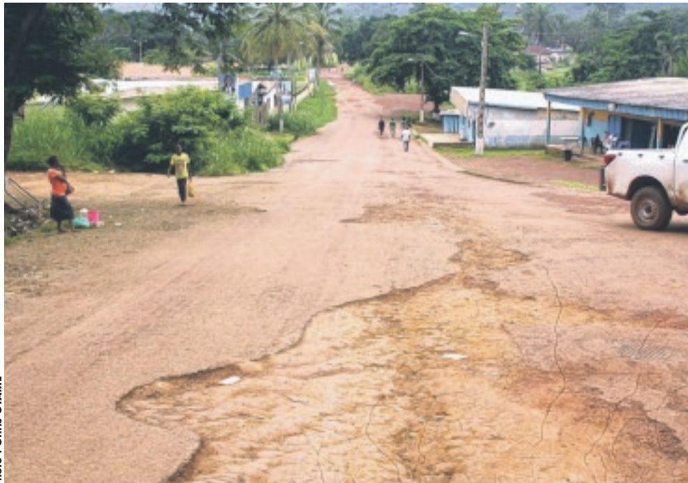
La principale artère du quartier. A reconstruire.
