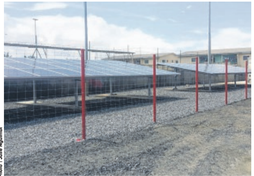
L'énergie solaire prévue pour alimenter les installations.
