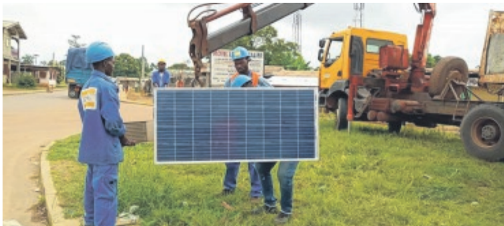
Plusieurs panneaux solaires ont été installés dans diverses localités.
