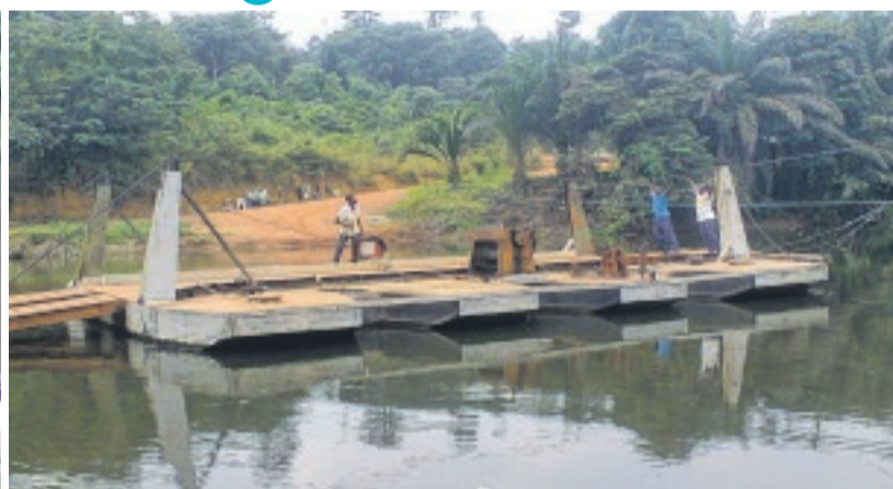
... le bac, ici avant d'être endommagé par l'engin compacteur des TP.
