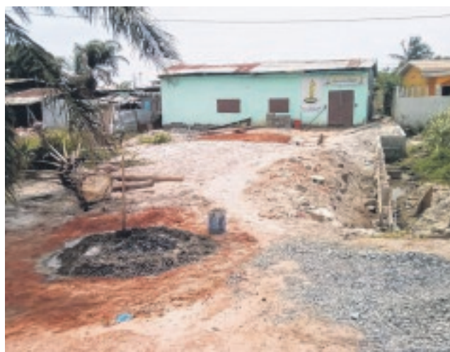
Des travaux ont été entrepris pour endiguer certaines portions de la conduite d'évacuation d'eau.
