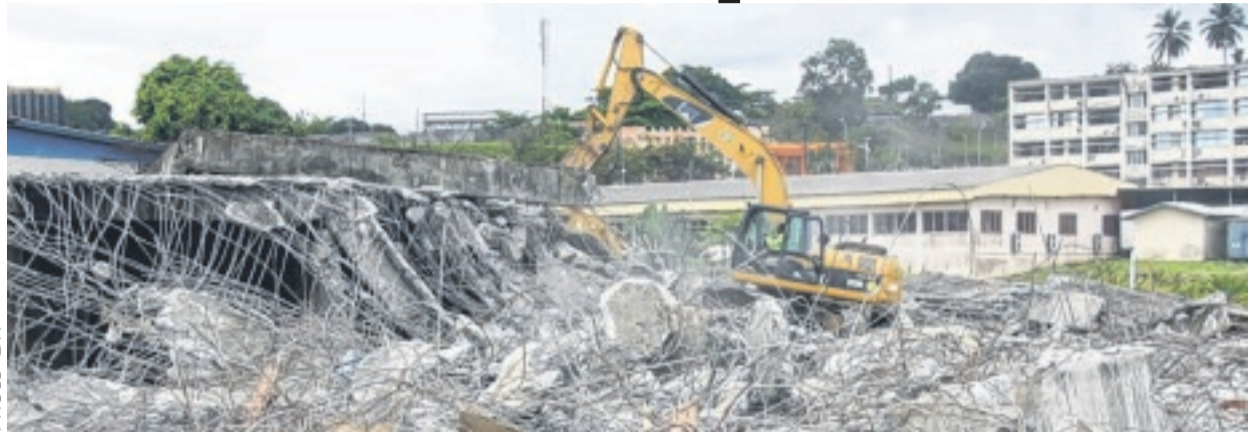
Le «Bunker» n'est plus désormais qu'un tas de ruines.
