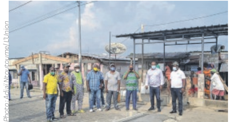
Photo: Adjaï Ntoutoume/L'Union Les membres du collectif des populations d'Avéa présentant au maire de Libreville un dos-d'âne en construction
