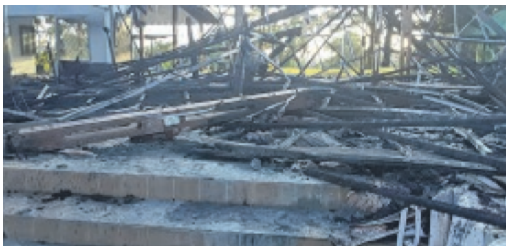
L'ampleur des dégâts.
