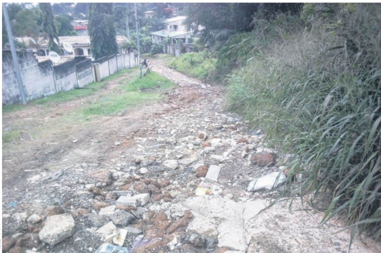
Une route accidentée au quartier Awoungou.
