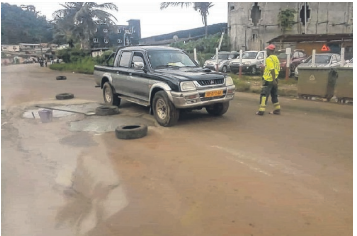
Une partie d'une voie secondaire «réparée» dans un quartier de Libreville.
