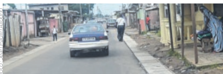
Photo: Jean-Paulin Allogo La voie routier Interphoto-route des citées unies a été réhabilitée.
