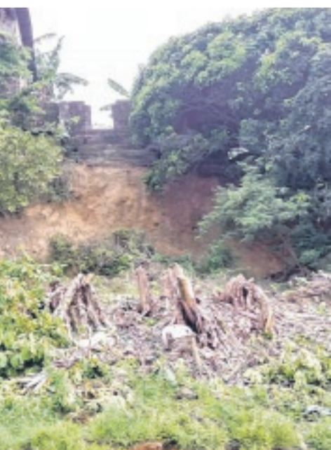
osées aux risques d'éboulements.
