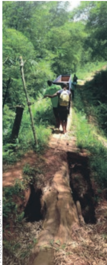
L'affaissement du pont pénalise fortement les habitants de cette région.
